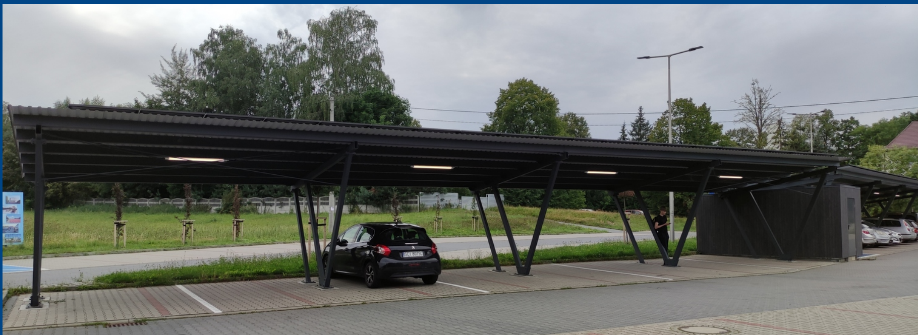
Instalacja fotowoltaiczna na parkingu przy kościele w Warszowicach
